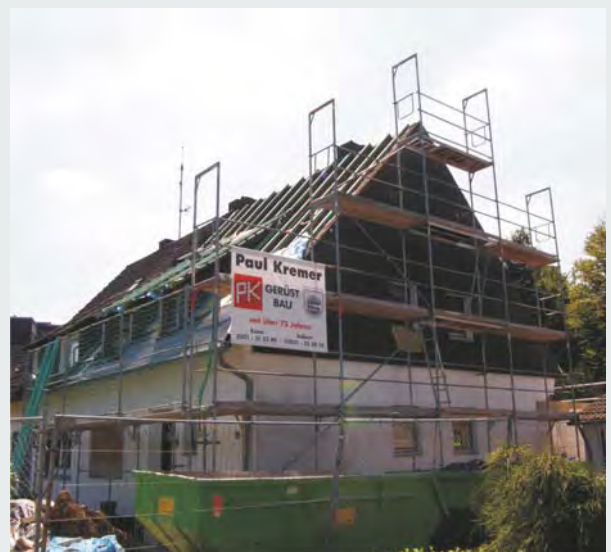
Bauvorhaben Hemmerhof, Überrauch
