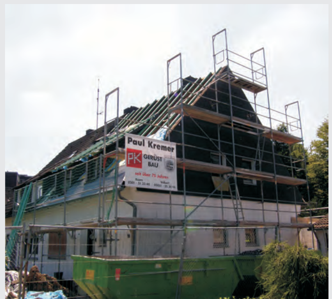
Bauvorhaben Hemmerhof, Überrauch
